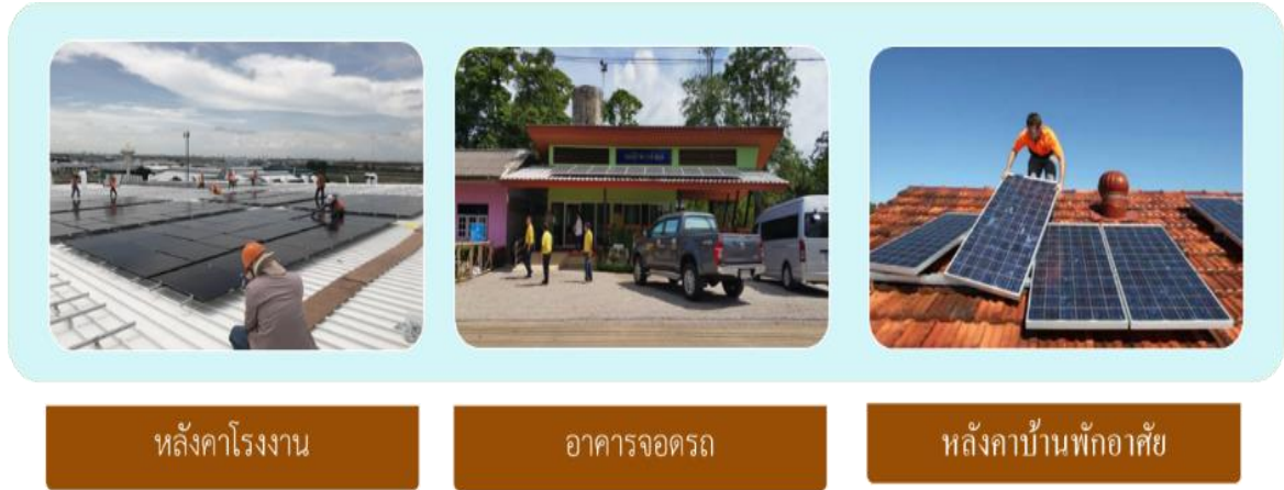
รูปที่ 7 ตัวอย่างการติดตั้งโซลาร์เซลล์
